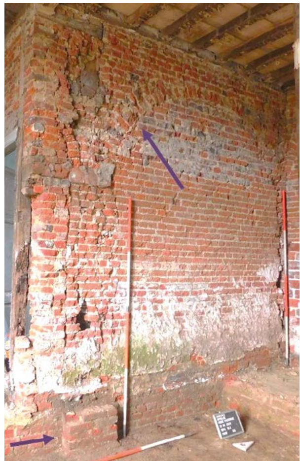
Fig. 2 Werkput 4 (inkom/gang), profiel W met aanduiding van het restant van een graatgewelf (bovenaan) dat grotendeels weggebroken is voor de verhoging van de pastorie en met onderaan een verbreding ter hoogte van de fundering waar de kracht van het gewelf naar beneden werd overgebracht.
