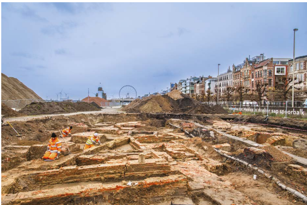
Fig. 1 Funderingen en kelders van de 13de-eeuwse bouwfase van de Sint-Michielsabdij (© Stad Antwerpen, foto Frederik Beyens)
